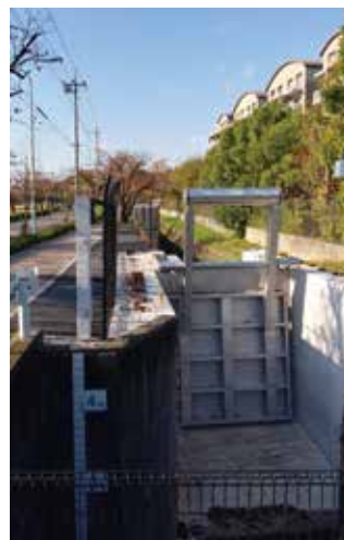
浸水被害を軽減するための逆流防止ゲート
